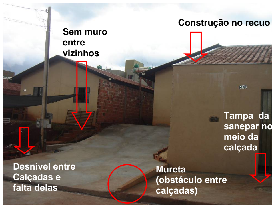
Figura (exemplo 08) – Rua 12 com obstáculos na calçada e quintal
