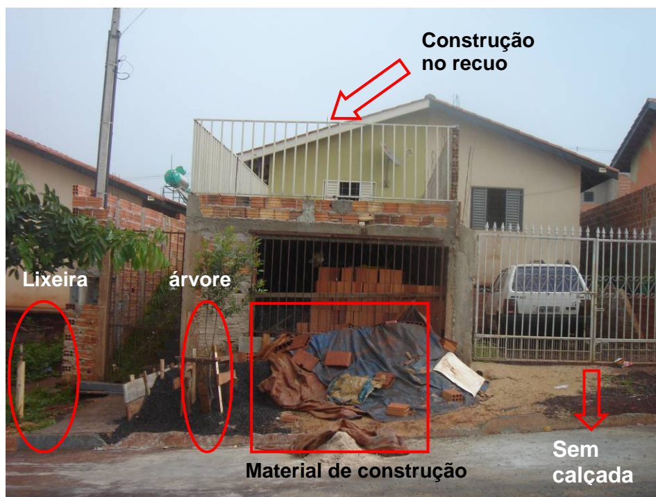
Figura (exemplo 23) – Rua 15 com obstáculos na calçada e quintal
