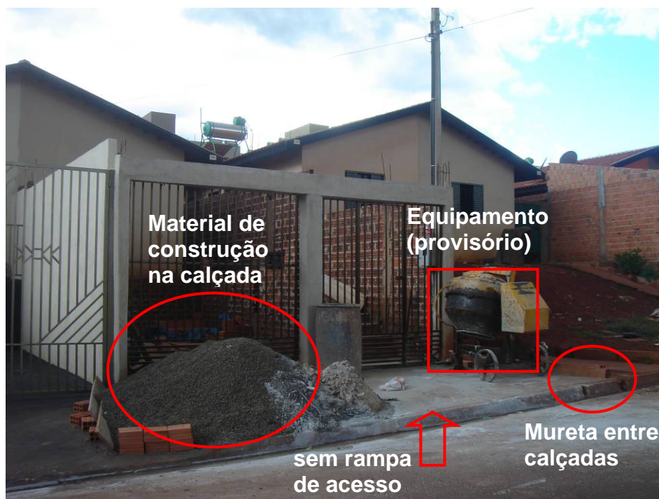
Figura (exemplo 09) – Rua 10 com obstáculos na calçada e quintal
