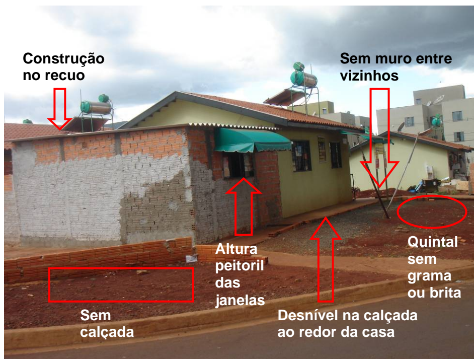
Figura (exemplo 17) – Rua 04 com obstáculos na calçada e quintal
