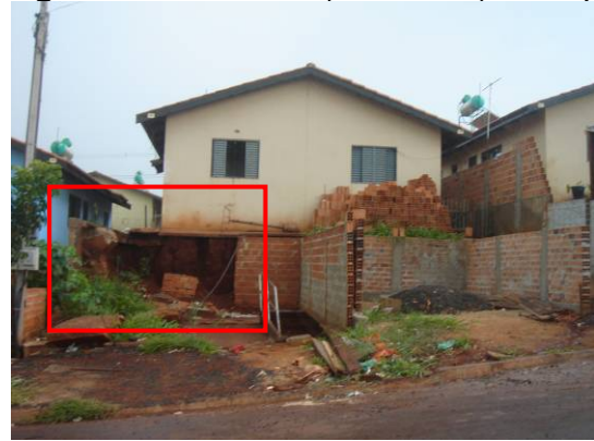
Figura 13 – Acesso (destruído) casa padrão
