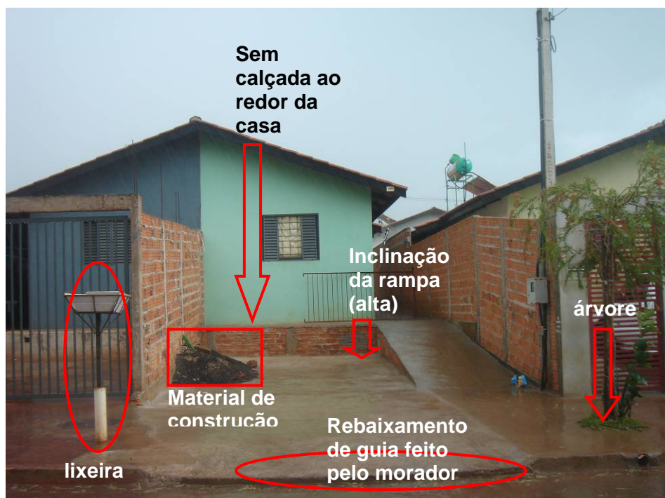
Figura (exemplo 26) – Rua 11 com obstáculos na calçada e quintal
