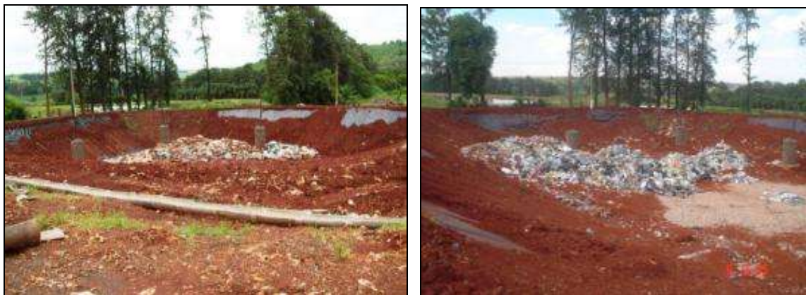
Figura 09: Vala impermeabilizada de Ibiporã em março de 2010. Autor: Caio Dalla Zanna.
