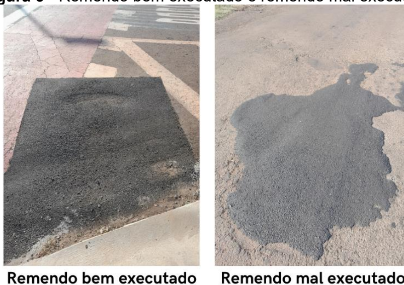
Figura 3 - Remendo bem executado e remendo mal executado
