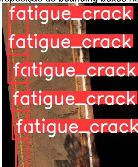
Figura 44 – Sobreposição de bounding boxes na trinca por fadiga
