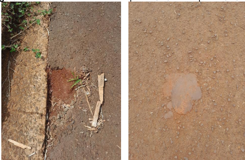
Figura 35 - Defeitos não detectados pelo YOLOv11s e pelo YOLOv12s
