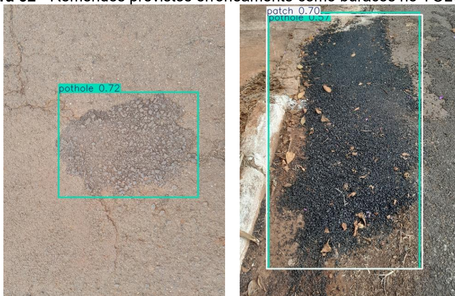
Figura 32 - Remendos previstos erroneamente como buracos no YOLOv11s
