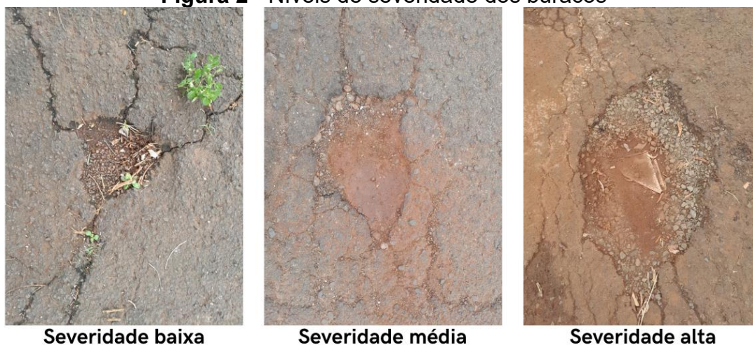
Figura 2 - Níveis de severidade dos buracos
