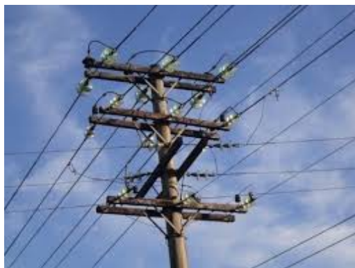
Fig.40-Estrutura em zona urbana para distribuição em 138kV
