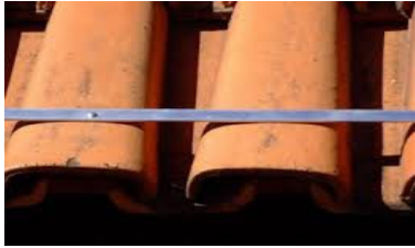
Fig.06. Fita metálica como captor
