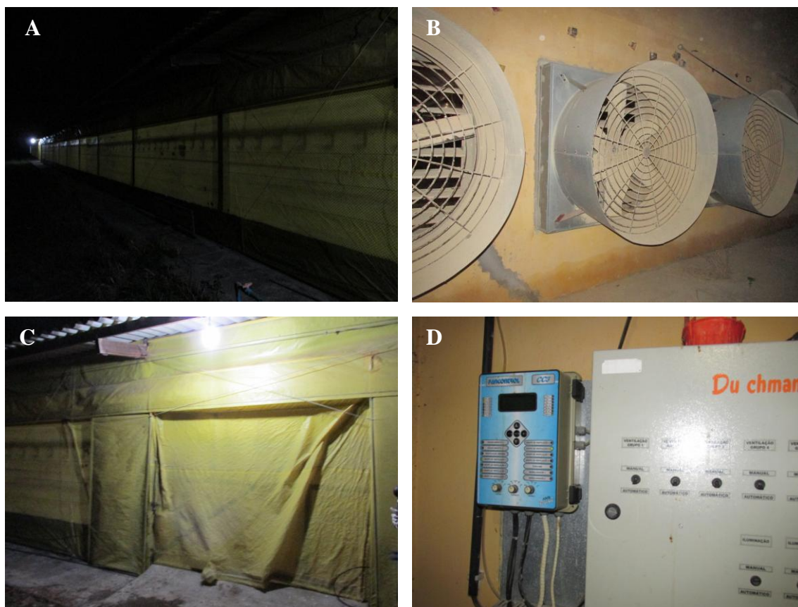
Figura 7. A. Barracão com as aves alojadas. B. Ventiladores utilizados no barracão. C. Parede lateral com a cortina plástica. D. Sistema de controle automático de temperatura e umidade relativa do barracão.
