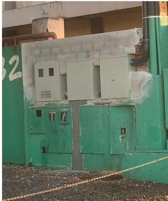
Figura 12 – Caixas de Entrada de Energia da Sulfiltros
