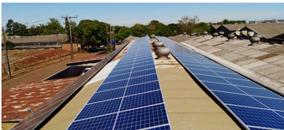
Figura 14 – Foto das placas instaladas na Sultech
