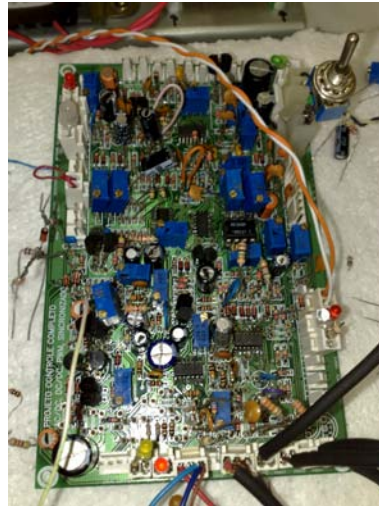
Figura 4.42 – Foto do circuito de controle.
