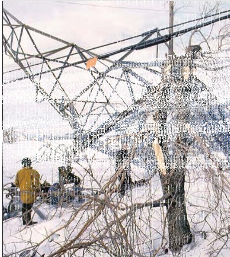
Figura 2.8 – Torres caídas de linhas de transmissão - Foto: Jeff Wang - Tyco Electronics.
