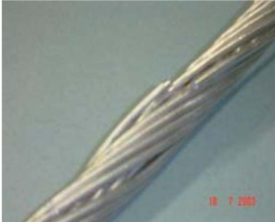
Figura 2.5 – Ruptura de um dos fios condutores de um cabo - Foto: Sarah Chao Sun - Dulhunty Power - Australia
