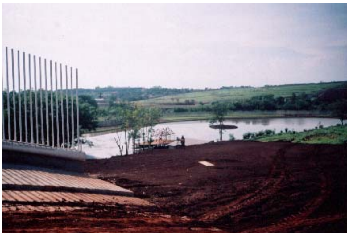
Autora: A. Perini, 2003 Obras em construção de um condomínio horizontal fechado com represamento,
