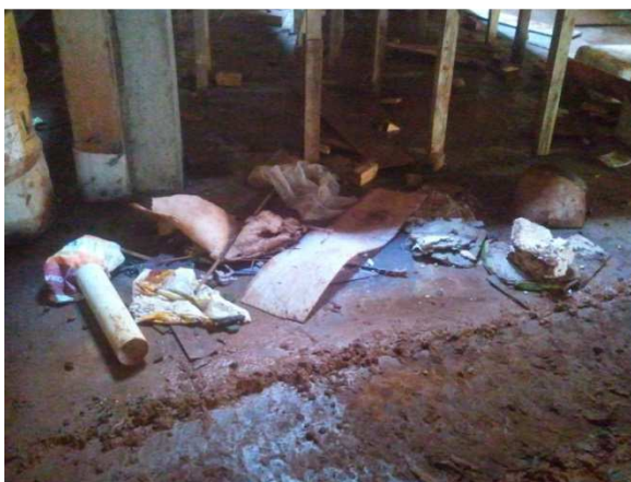
Figura 21 – Resíduos recicláveis misturados despejados sobre o solo na Obra A.
