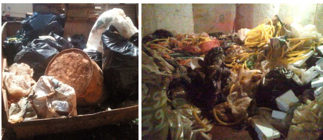
Figura 20 - Caçamba com diversos tipos de resíduos e baia de resíduos classe B com diversos tipos de recicláveis misturados - obra A
