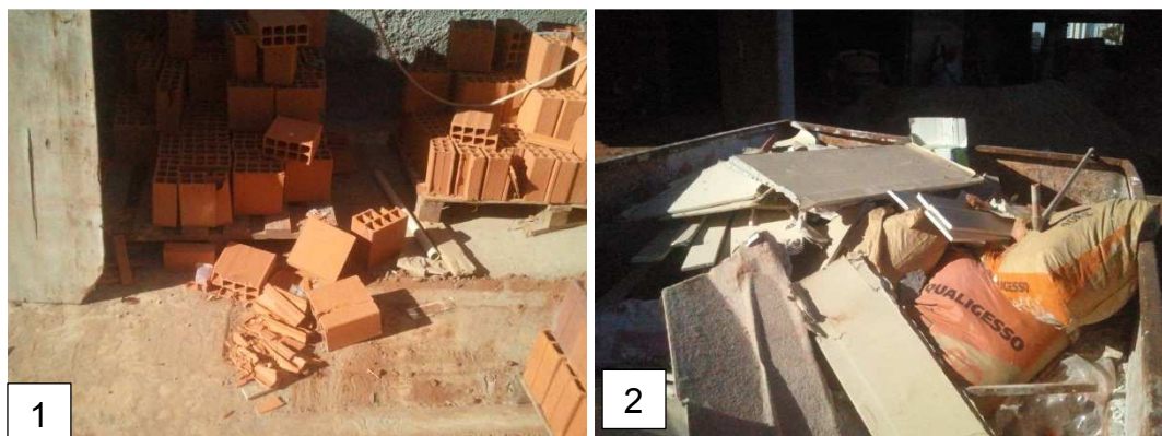
Figura 41 - Exemplo de desperdício de matéria-prima – tijolos não utilizados quebrados e grande quantidade de gesso.
