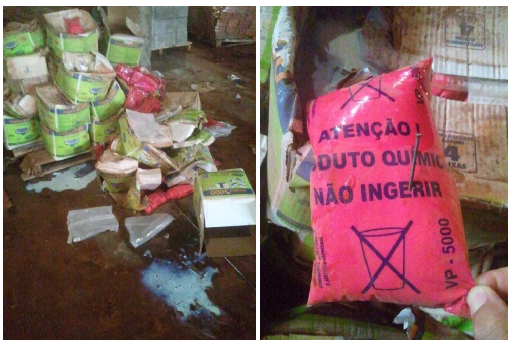
Figura 18 - Desperdício de material obra A – aditivo de argamassa derramado pelo chão
