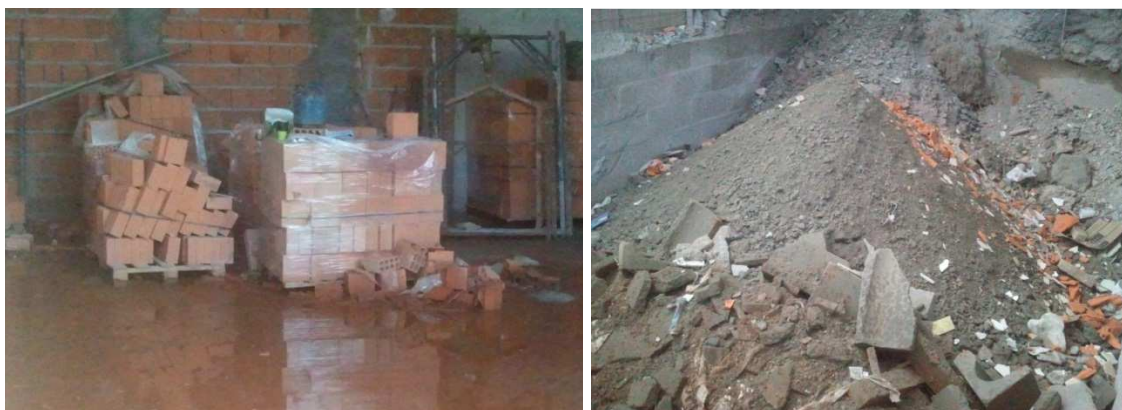
Figura 19 - Desperdício de tijolo e argamassa Obra A
