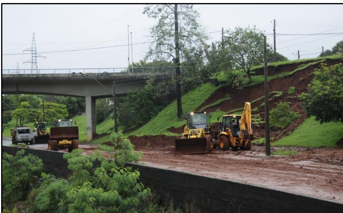
Figura 46 – Talude exemplo – Londrina.
