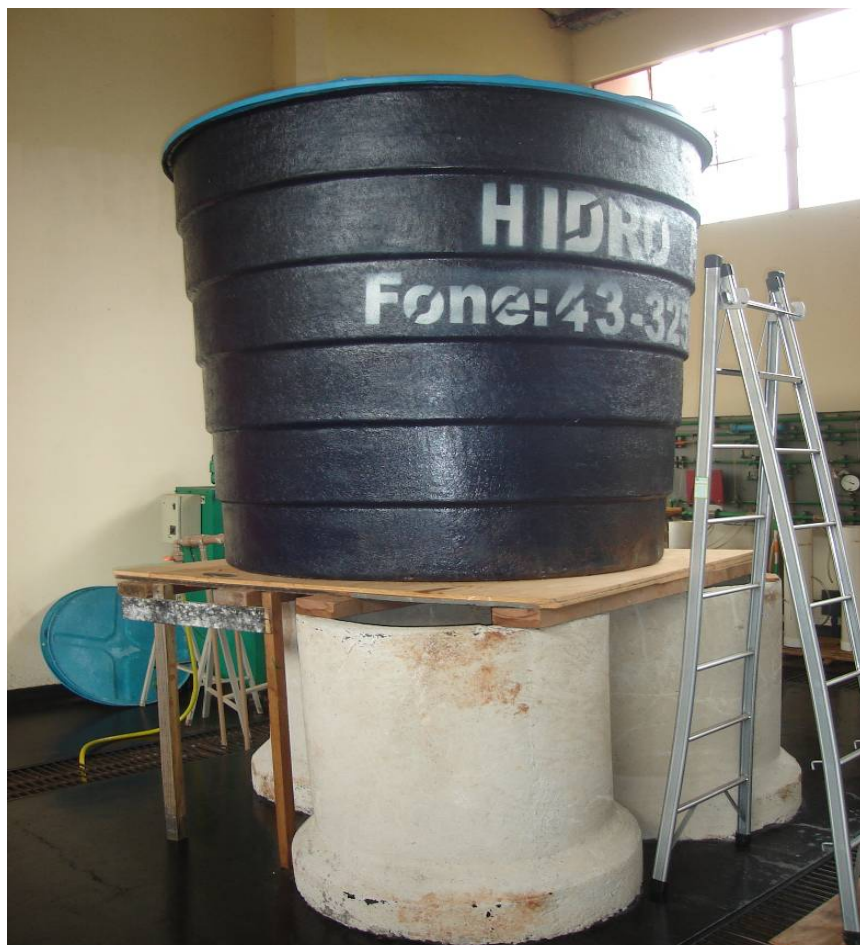
Figura 10 - Tanque de armazenamento do lixiviado bruto.
