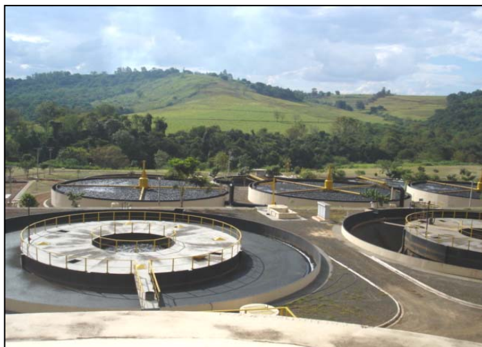
Foto 6 – Decantadores e reatores na ETE Sul de Londrina
