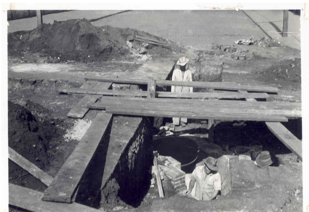
Imagem 13 - Tanque flexível- cruzamento da Avenida Higienópolis.
