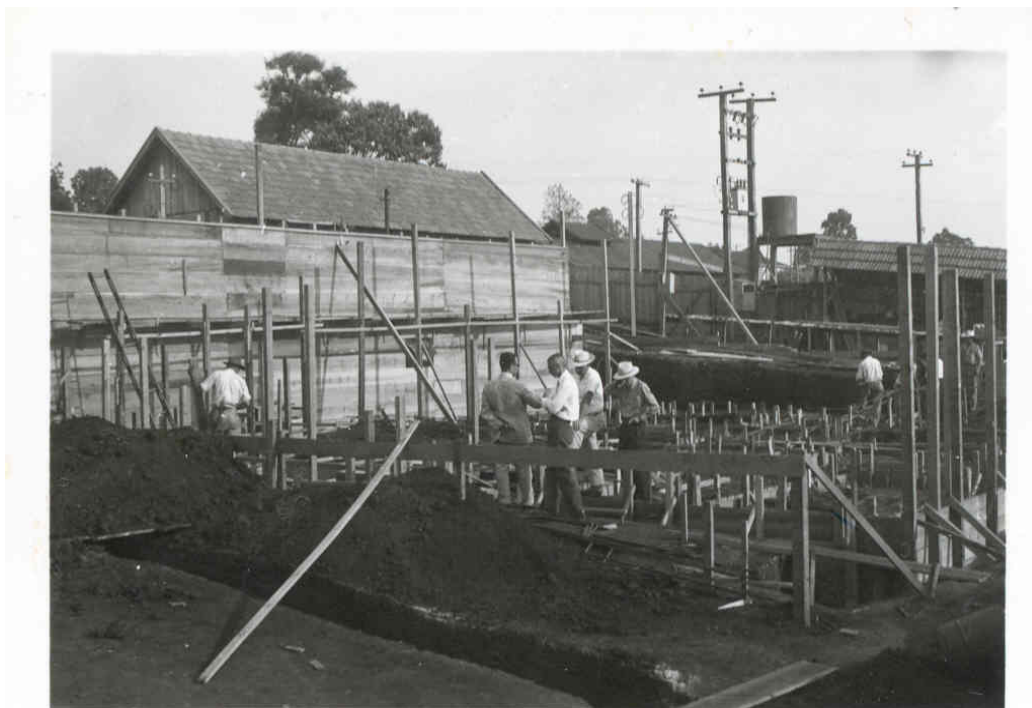
Imagem 16 - Ampliação da Estação de Tratamento de Água, localizada na Rua Antonina.
