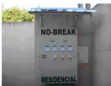
Figura 3.19 – Fotografia do Protótipo do No-Break instalado.
