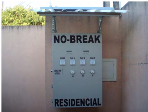
Figura 4.18 – Circuito do UPS instalado em uma residência
