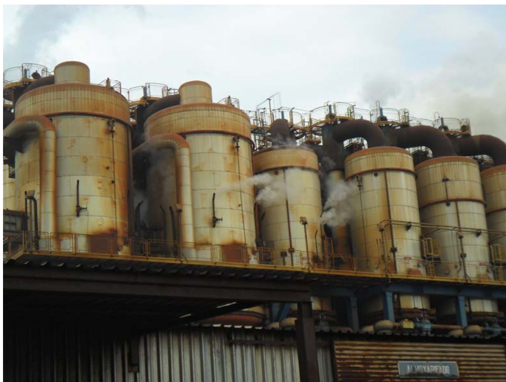
Figura 23 – Caixas de evaporação, Usaçúcar
