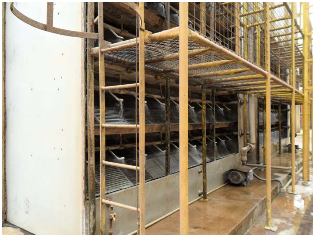
Figura 16 – Caixa de resfriamento, Usaçúcar, (2012)
