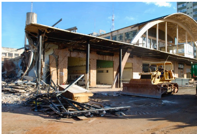
Figura 39 - Demolição da Estação Rodoviária Municipal Prefeito Américo Dias Ferraz , 27 de maio de 2010
