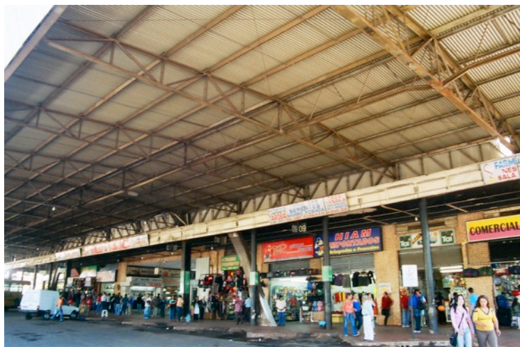
Figura 33 - Parte da estrutura metálica cujo desabamento deu origem às ações de desapropriação e demolição pelo poder público, em 13 de agosto de 2005
