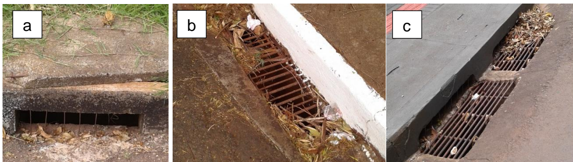
Figura 5.7 - Exemplo de boca de lobo com entrada apenas pelo meio fio (a), apenas pela rua (b) e dupla com entrada pela rua e meio fio (c)
