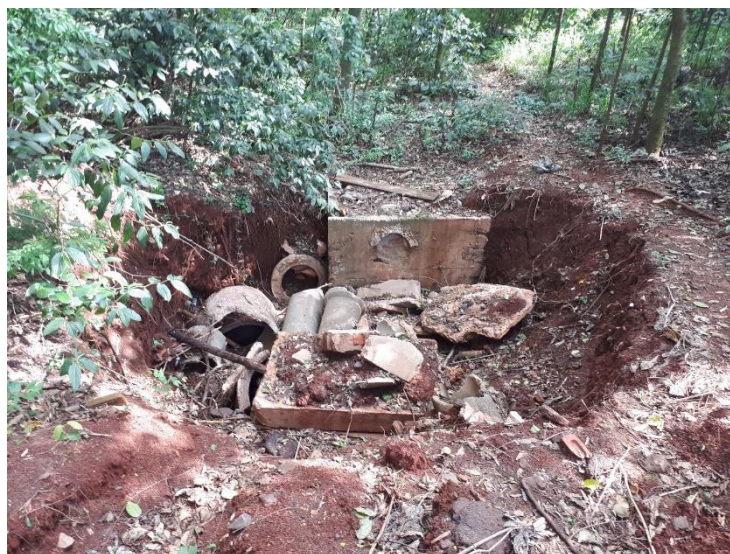
Figura 5.9 - Exemplo de galeria de águas pluviais danificada no córrego 3c
