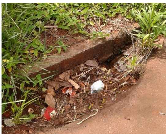
Figura 5.8 - Exemplo de boca de lobo obstruída
