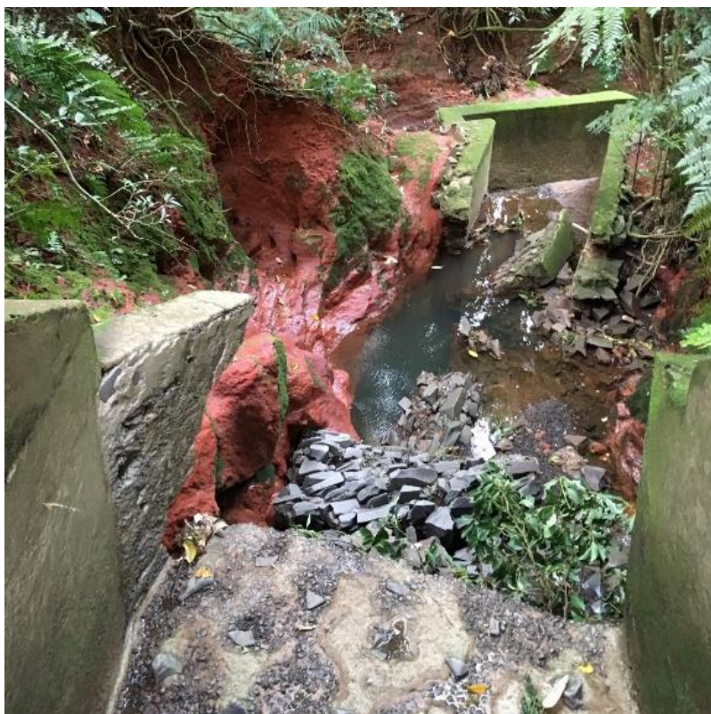
Figura 5.10 - Exemplo de dissipador de energia destruído no córrego 3b
