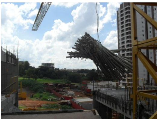
Figura 25: Transporte arriscado das escoras metálicas
