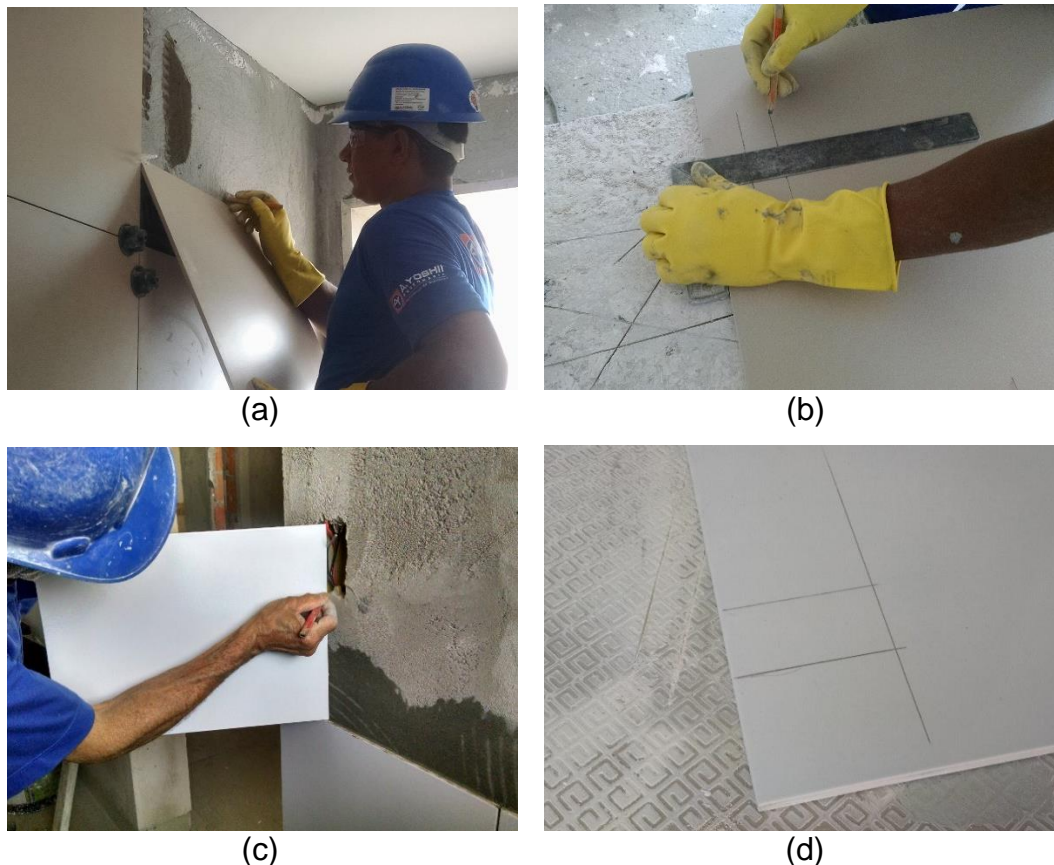
Figura 21 – (a ) e (b) Simulação da peça no local para demarcação do corte com precisão dimensional e; (b) e (d) linhas de referência da região do corte
