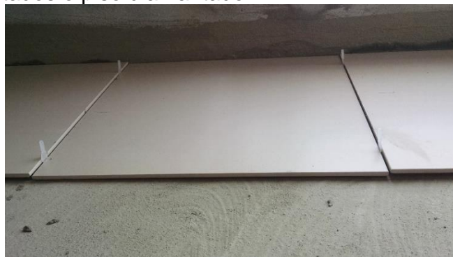
Figura 28 – Colocação temporária de peças sem argamassa nos locais onde serão executados o piso diamantado
