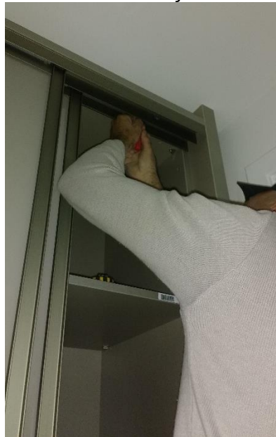
Figura 14 – Execução de ajustes para correção de falhas na abertura da porta identificadas por meio da simulação
