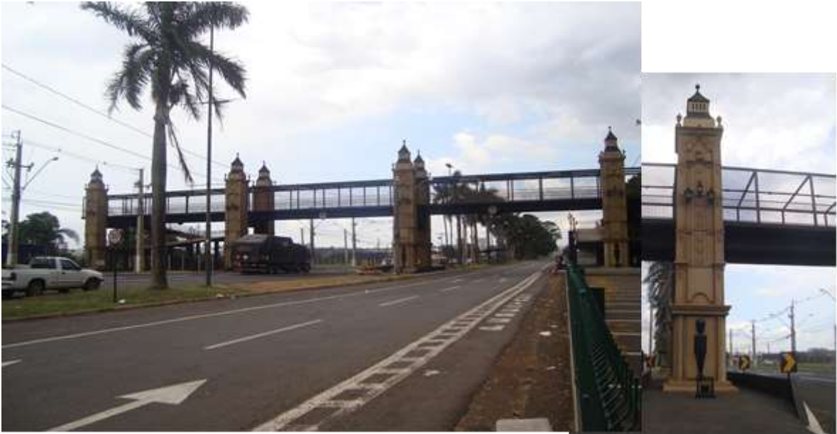
Figura 26 – Portal da entrada de Londrina sentido Londrina – Cambé; Passarela da Avenida Tiradentes, em Londrina, PR (2016). Destaque para uma das torres.
