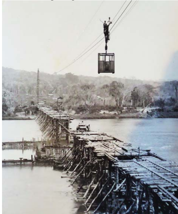
Figura 1 – Vista geral do escoramento provisório da ponte, mostrando o parapeito no canal principal e a cabine de passageiros do cabo aéreo
