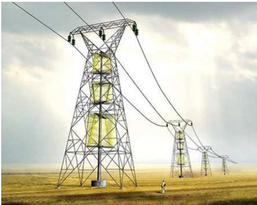
Figura 2.2: Exemplo de torre para ancoragem de cabos em redes aéreas de distribuição e transmissão de energia elétrica. Fonte: TreeHugger.
