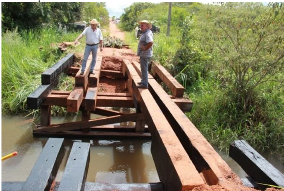
Figura 20 – Ponte parcialmente destruída em via de acesso ao Assentamento São Sebastião
