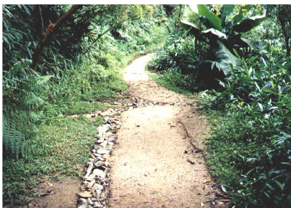
Foto 21 Drenagem para água pluviais.
