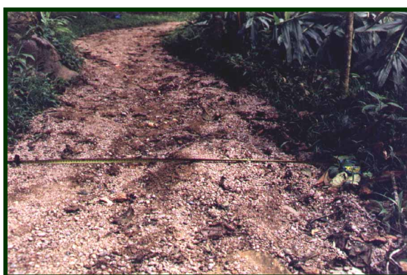
Foto17 Erosão na rampa de entrada ocorrida com apenas dois meses de término dos trabalhos (PETAR, 2003)
