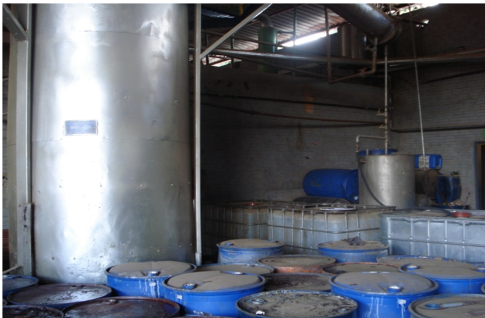
Figura 5 - Reator de Solventes. Fonte: CETEC, 2009.
