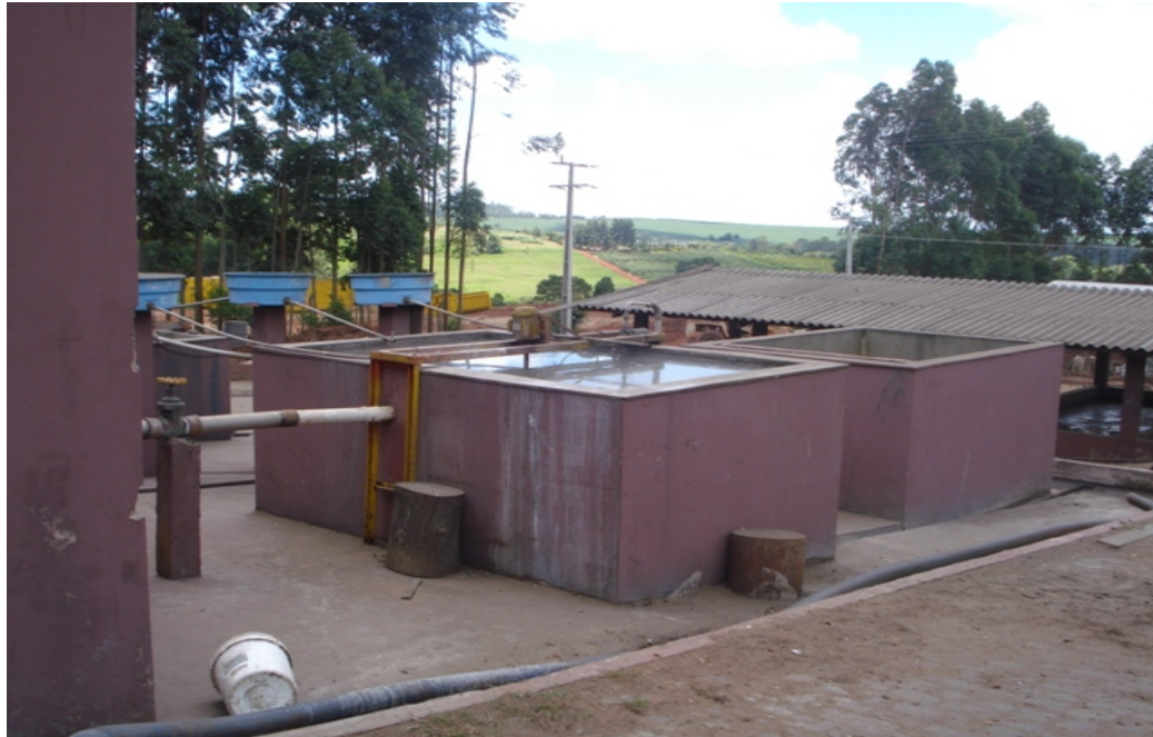
Figura 6 – Tratamento de água por decantação. Fonte: CETEC, 2009.
