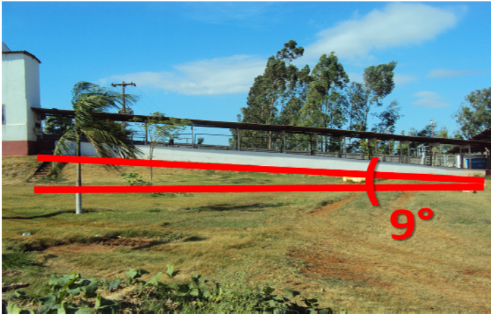
Figura 9 – Inclinação do corredor do frigorífico
