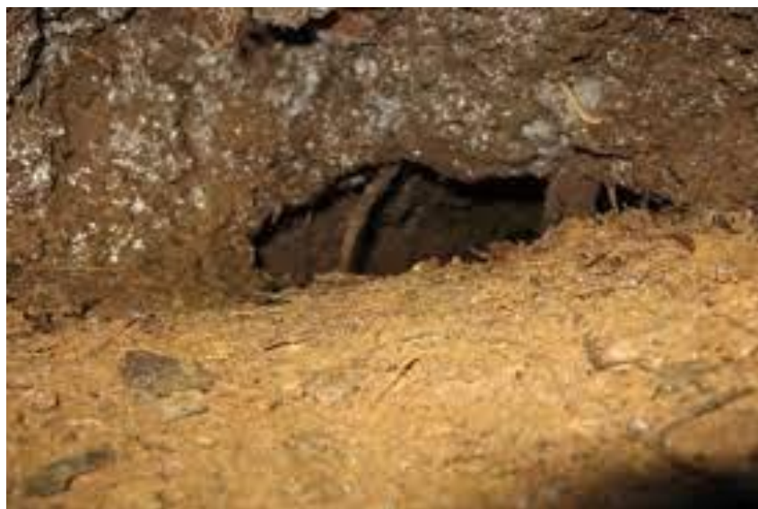
Figura 4 – Erosão em túnel Guarapuava – PR
