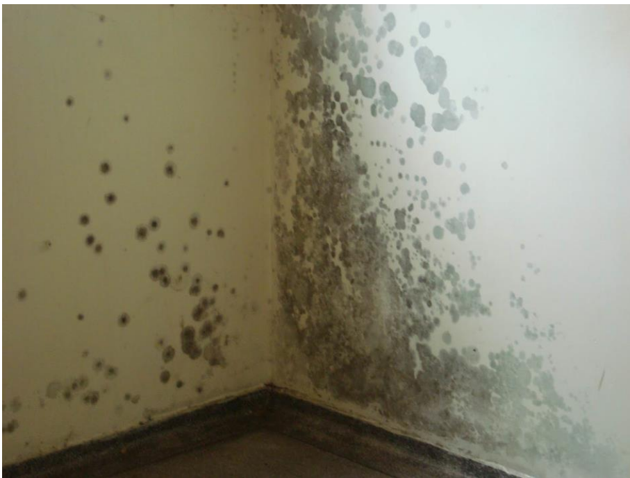
Figura 16 – Parede com mofo.
