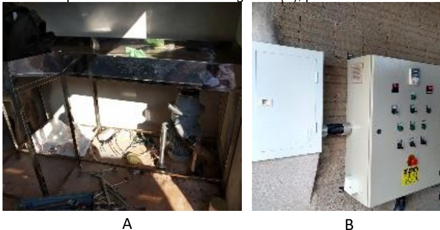
Figura 50 - Sistema de pré tratamento do resíduo orgânico (A), painel de controle da UP-BioUEL (B)
