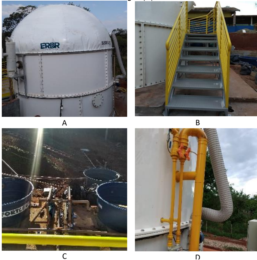
Figura 48 - Instalação da cúpula do reator CSTR (A), da escada e plataforma de acesso à parte superior do reator (B), sistema de bombeamento (C) e sistema de coleta, quantificação e transporte de biogás (D).
