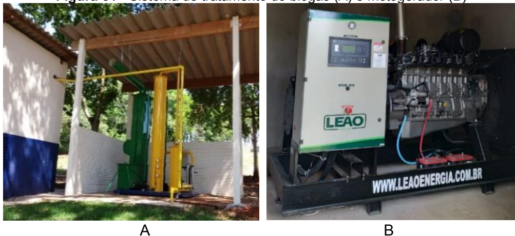
Figura 51 - Sistema de tratamento do biogás (A) e motogerador (B)
