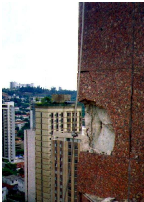
Figura 2.2: Ruptura de fachada por corrente de descarga atmosférica proveniente do sistema de descida do aterramento. Fonte:(ALVES, 2006)
