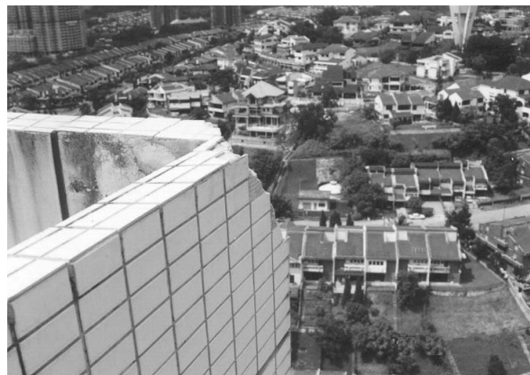
Figura 3.8: Beiral atingido por descarga atmosférica. Fonte: (Hartono 2000)
