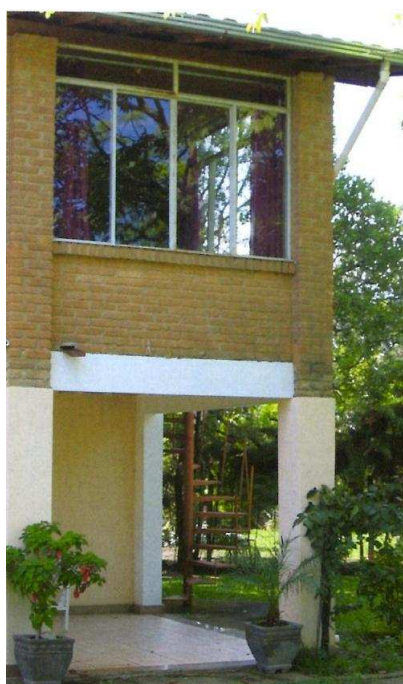
Figura 3.11: Edificação rural atingida por descarga. Fonte: (ALVES, 2006)
